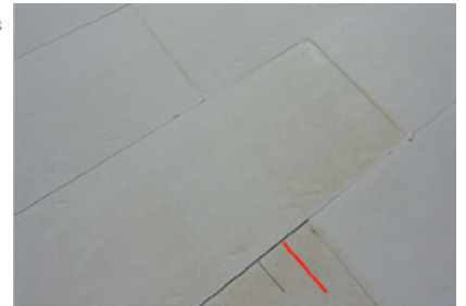
Slika 6: Primer slabo zatesnenih stikov
